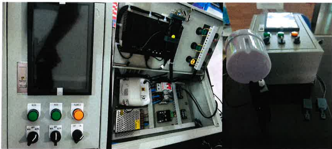
(ก) หน้าแสดงผลและควบคุม (ข) อุปกรณ์ภายในตู้ควบคุม (ค) เซนเซอร์ตรวจวัดภายในโรงเรือน
